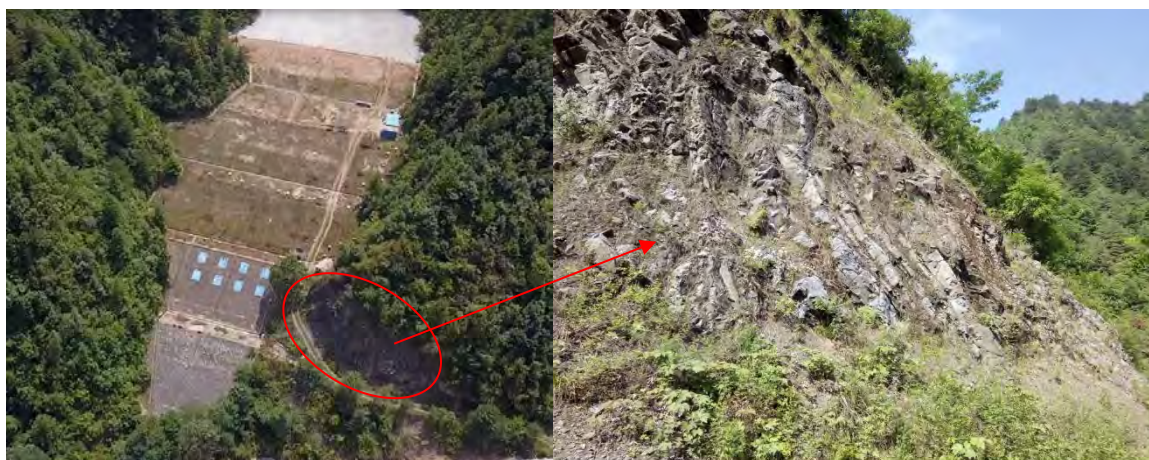
照片（组）3-4 老厂沟沟口不稳定边坡
